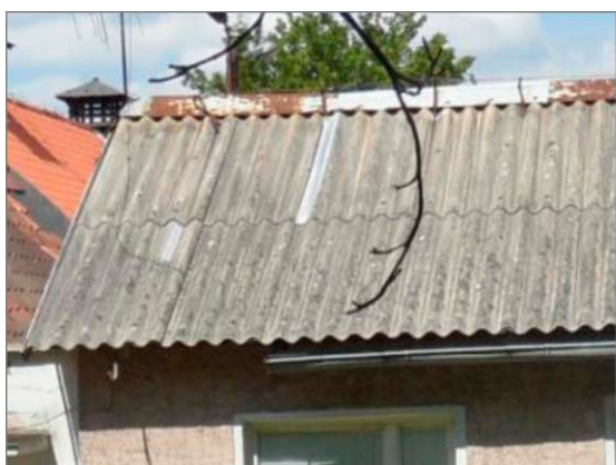
Fot.1 Płyty azbestowo-cementowe faliste
